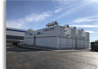
G&W Electric (2022) Bolingbrook, IL
